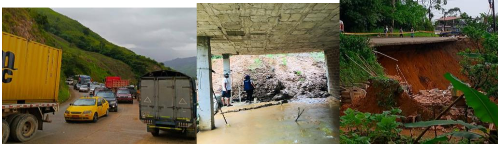
2 de marzo de 2025 Verificación de novedades debido a lluvias en la vía estatal sector El Triunfo y el Doblado, afectaciones en vivienda en Buenavista. 5 de marzo 2025. Verificación del socavón en el barrio El Progreso
