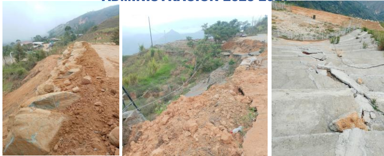
2 de octubre 2025. Constatación de construcción del muro con piedras en el sitio El Estadio con la finalidad que el terreno califique para vivienda social, estado del recinto ferial El Limoncillo
