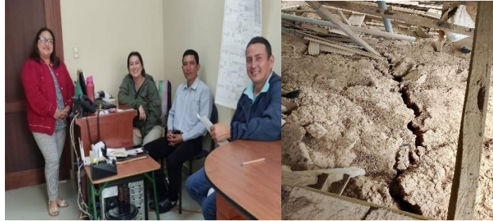
18 febrero 2025 Levantamiento de información acerca de la Junta Cantonal de Protección de Derechos Verificación de grietas en la parte posterior de la casa del Sr. Vidal Rentería, sector La Alborada.
